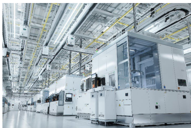
工場・プラント設備
