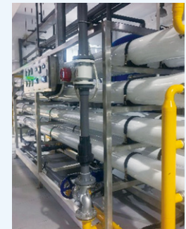
純水製造装置
